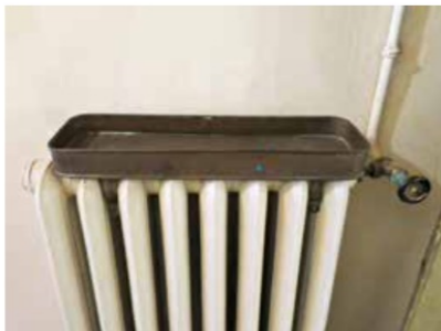
Messinkipeltinen patterin päällä lepävä ilmankostutin.
